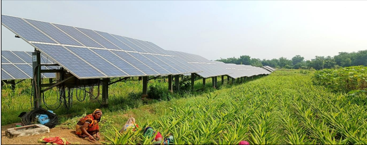
(a): GIPCL AgriPV plant, Amrol, Gujarat
